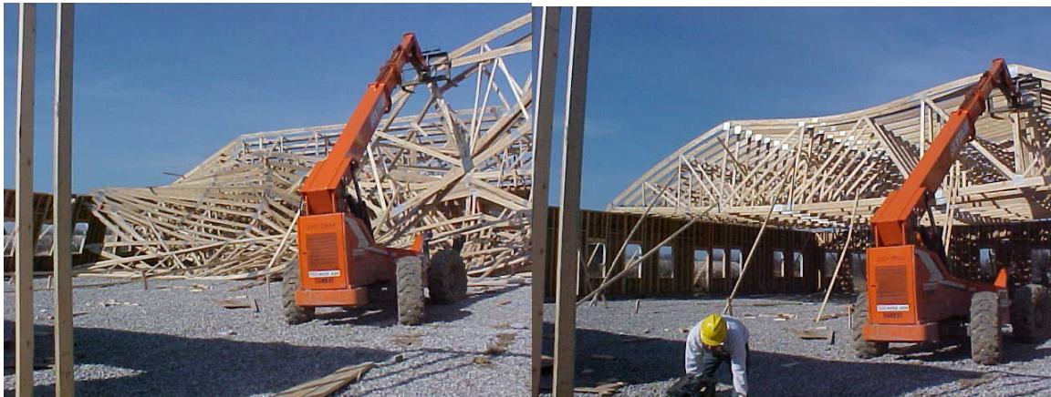
شکل ۱-۵-الف- سقف قبل از نصب.....ب- ریزش سقف
